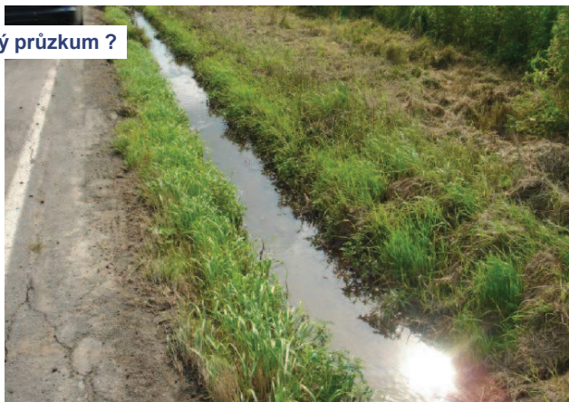
Špatná údržba povrchového odvodnění
