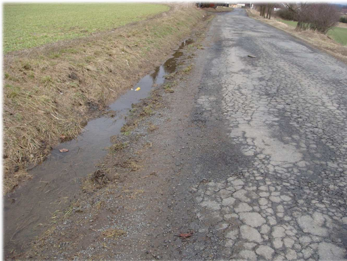
Stojící voda v nevyčištěném příkopu
