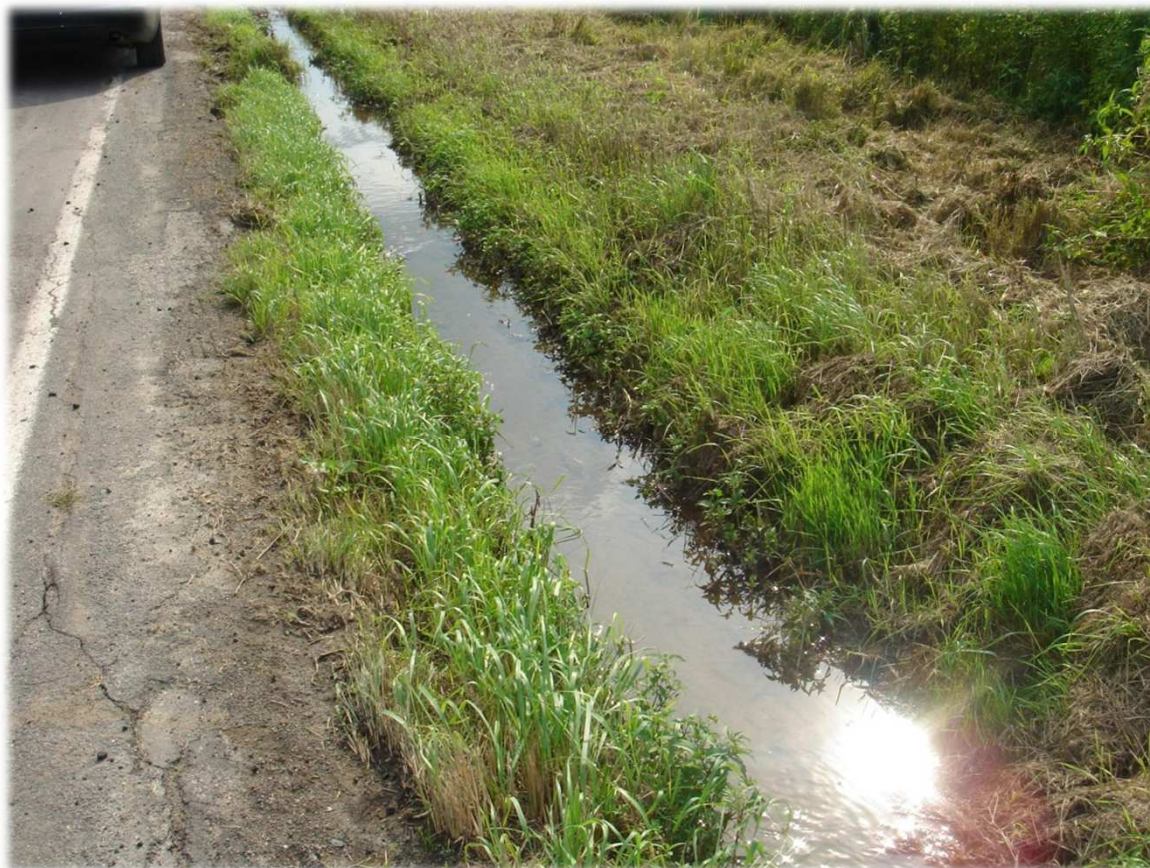
Stojící voda v nevyčištěném příkopu
