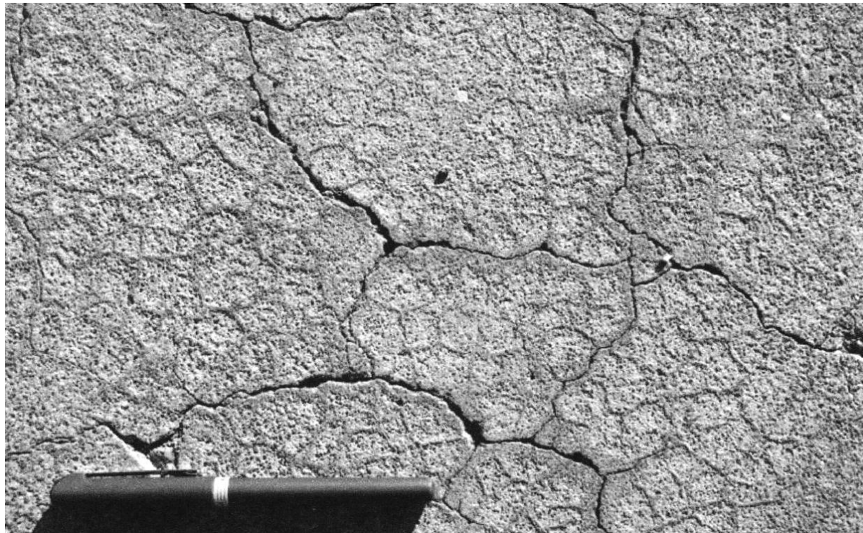
Typický projev alkalické reakce na povrchu cementobetonové vozovky
