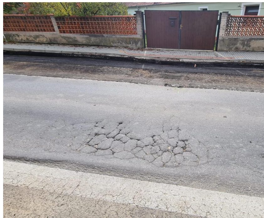
Síťové trhliny nad překopem – zásyp pod AC vrstvami z HDK frakce 8/16 – sil. I/22
