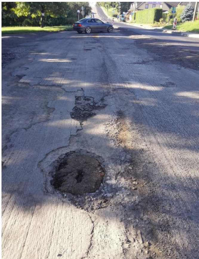
Výskyt stromů v konstrukci vozovky sil. I/38
