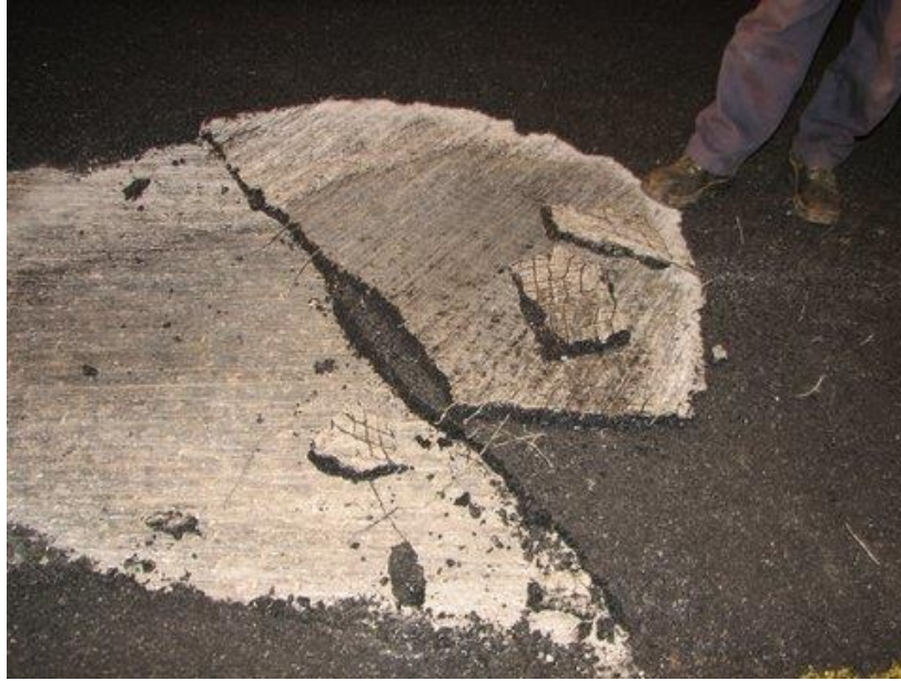
Instalace pod obrusnou vrstvu s nedostatečným krytím z AC vrstev
