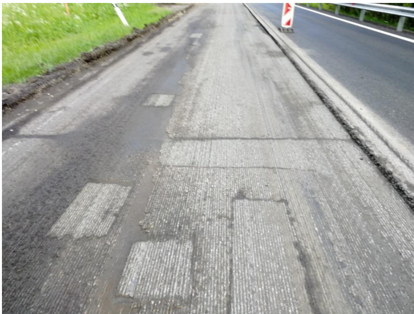
Historické opravy obrusné vrstvy na niveletě – 110 mm Sil. I/38)
