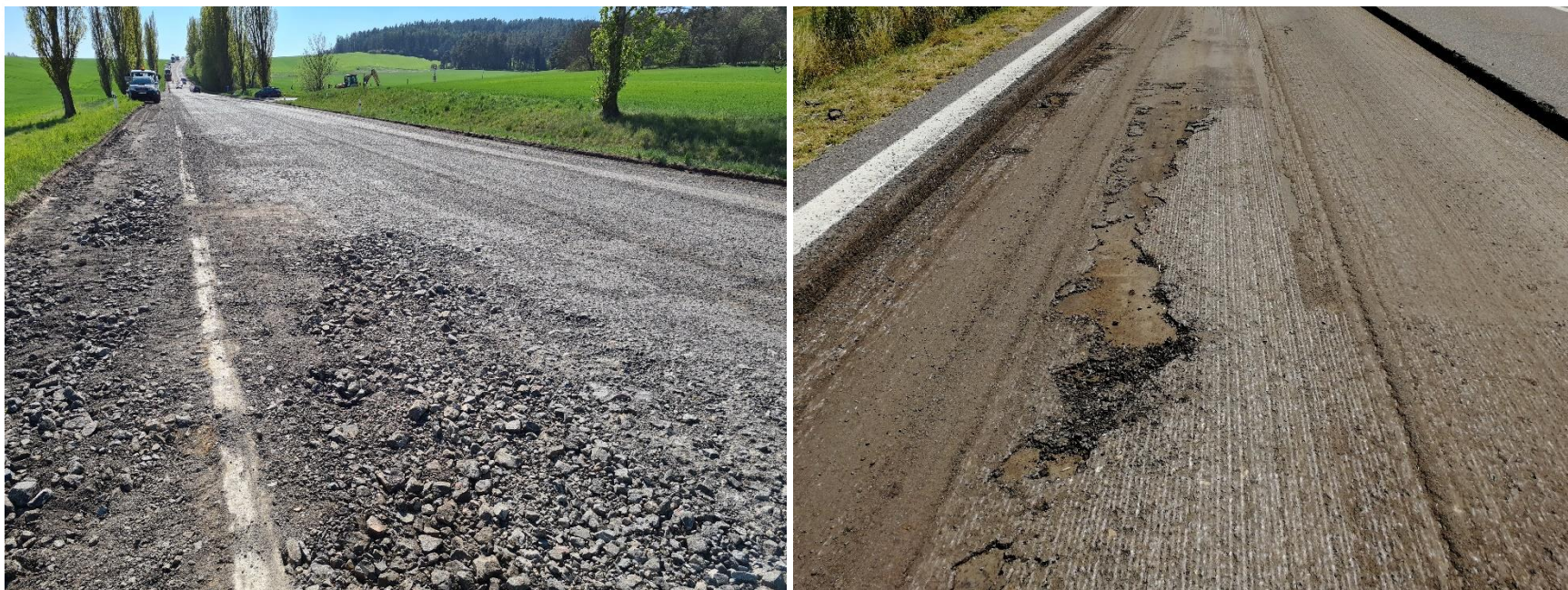
Stav porušení zbytkových AC / PM vrstev sil. I/4, I/19
