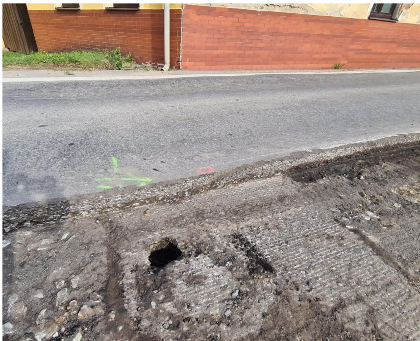
Porušená kanalizace na niveletě – 200 mm – sil. I/22
