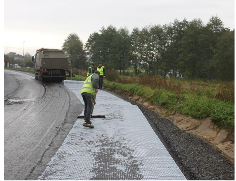
Instalace kompozita do již částečně vyštěpené emulze = nespojení s podkladem, nespojení vrstev
