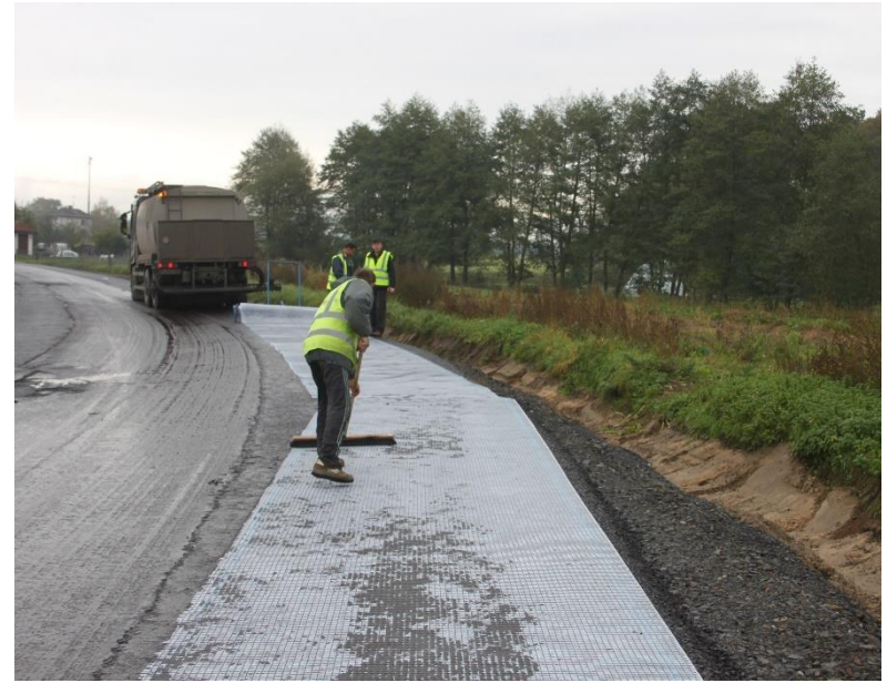
Instalace kompozita do již částečně vyštěpené emulze = nespojení s podkladem, nespojení vrstev
