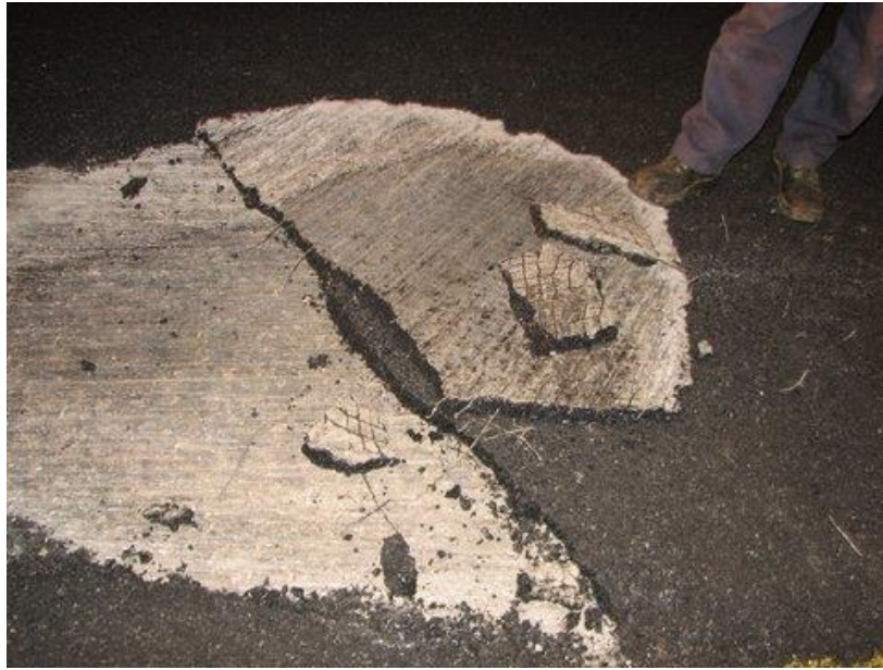
Instalace pod obrusnou vrstvou s nedostatečným krytím z AC vrstev
