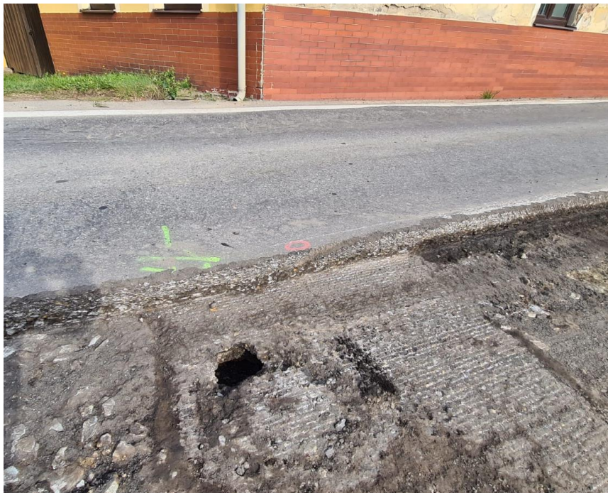
Porušená kanalizace na niveletě – 200 mm – sil. 1/22
