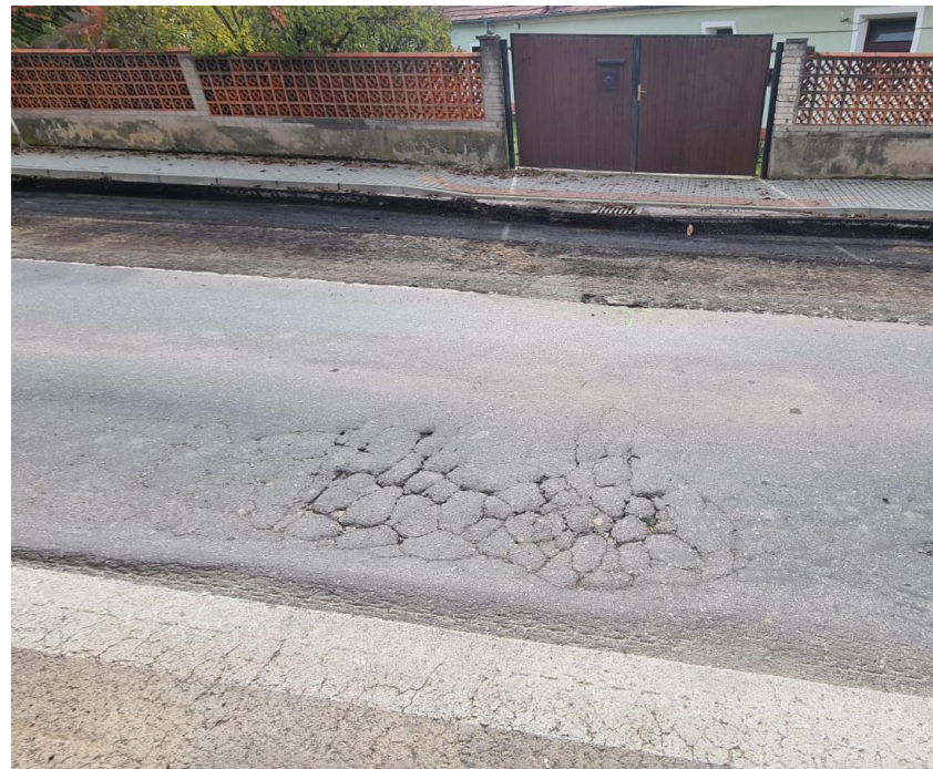
Sítové trhliny nad překopem – zásyp pod AC vrstvami z HDK frakce 8/16 – sil. 1/22
