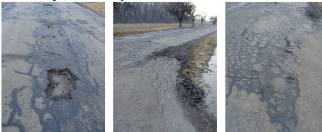
Poruchy konstrukčních vrstev – nutná celoplošná oprava / rekonstrukce
