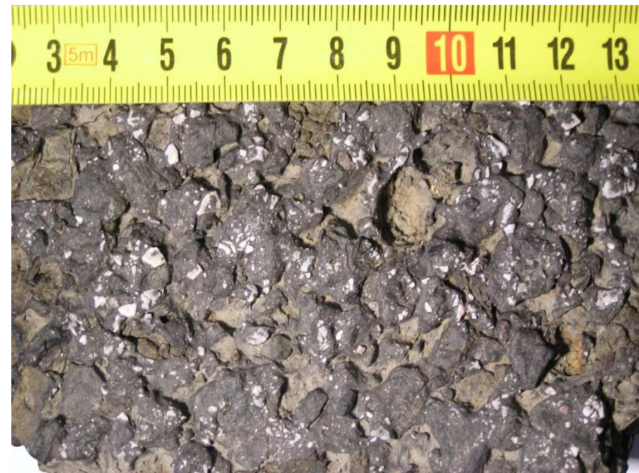
Rozpad čedičového kameniva v obrusné vrstvě
